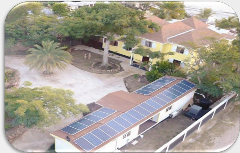
150KW Solar System Antigua 2018
